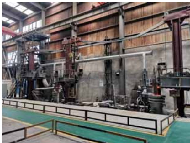
现有工程电渣重熔炉现状
